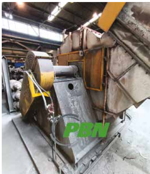
Ventilatore PBN in funzione dal 2005
